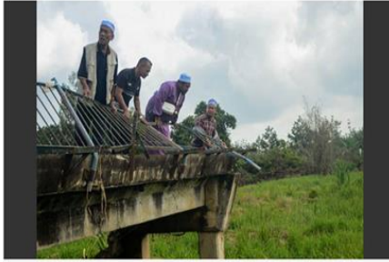
Penduduk meninjau keadaan jambatan yang runtuh selepas dihayutkan arus deras banjir pada 29 Nov lepas ketika perjalanan di Rong Cherek, Pasir Mas, pada Selasa. - Gambar Bernama
